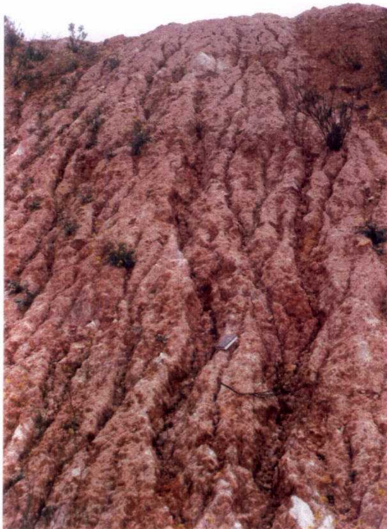
Erosión (cárcavas) en los taludes
